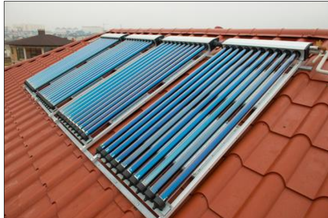
Bild 2: Thermische Solaranlage auf dem Dach eines Gebäudes. © Foto: Pavlo Vakhrushev - Fotolia.com
