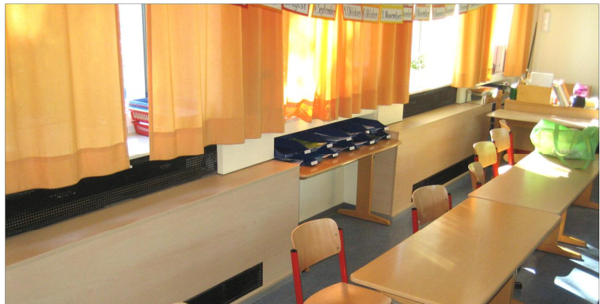
Bild 5: Dezentrale Lüftungsgeräte unter den Fenstern in einem Klassenraum der Freiligrath-Grundschule in Detmold. © Foto: e&u energiebüro
