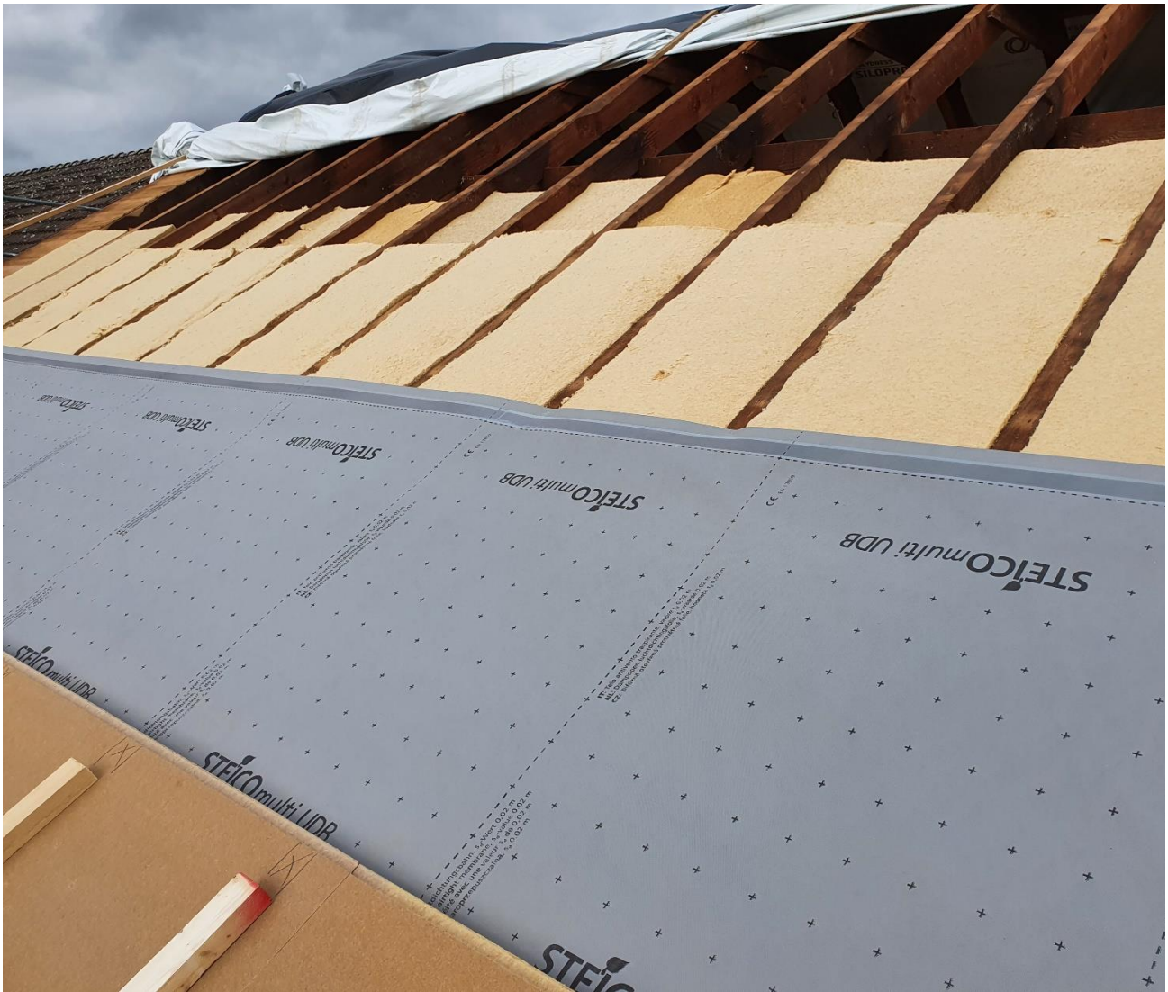
Abb. 6: Energetische Dachmodernisierung von außen. Interessanterweise konnte hier auf eine klassische Dampfbremse verzichtet werden, weil die Holzfaser-Dämmstoffe sehr feuchte-sorptiv sind und dafür sorgen, dass die Holzkonstruktion bei phasenweise hoher Dampfdiffusion trocken bleibt. Voraussetzung ist, dass die vorhandene Innenbekleidung ausreichend dampfbremsend ist. © Foto: STEICO
