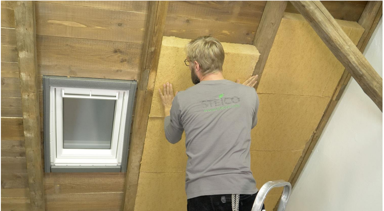
Abb. 2: Energetischen Modernisierung eines Bestandsdachstuhls von innen mit der Holzfaser-Dämmmatte STEICOflex 036 als Zwischensparrendämmung. © Foto: STEICO
