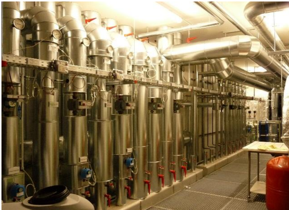
Bild 6: Technikzentrale der FOS/BOS Erding. Abgebildet ist im Vor- dergrund der Heizkreisverteiler und im Hintergrund der Kaltwasser- verteiler. Nachdem die Schule mit dem Fernwärmerücklauf geheizt und mit Außenluft bzw. teilweise mit Grundwasser gekühlt wird, sind keine Kesselanlagen oder Kältemaschinen erforderlich. Alle Kreise wurden mit Wärme-/Kältemengenzählern ausgestattet und
