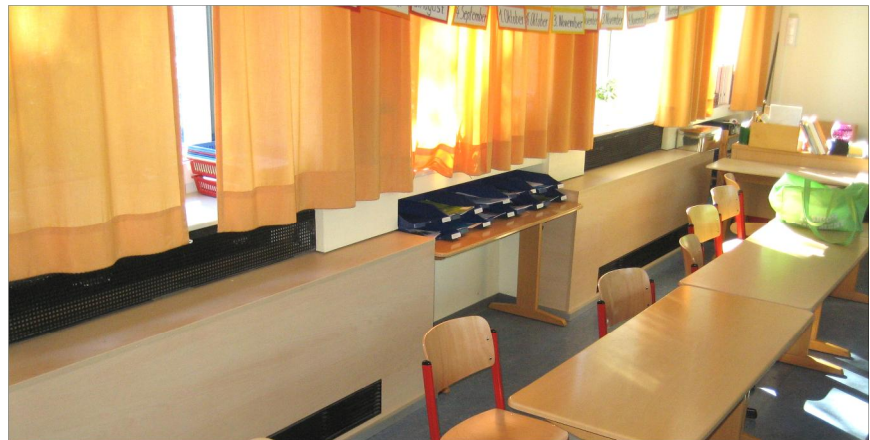
Bild 5: Dezentrale Lüftungsgeräte unter den Fenstern in einem Klassenraum der Freiligrath-Grundschule in Detmold. © Foto: e&u energiebüro
