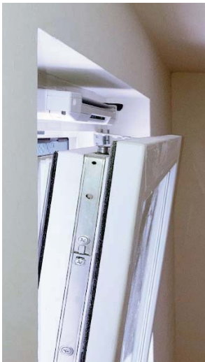
Bild 2: Arbeiterleichterung: Außenbauteil-Luftdurchlässe (ALD) für die freie Lüftung werden für den Blower-Door-Test zum öffentlich-rechtlichen Nachweis nach GEG nicht mehr abgedichtet. Foto: FLiB e. V.
