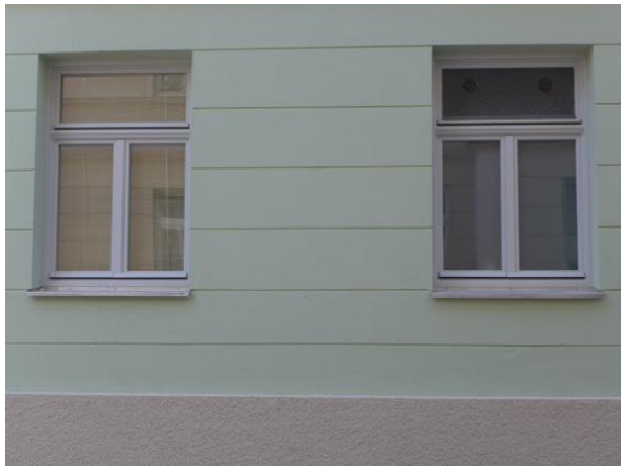
Bild 7: Details des sanierten Hauses: Das rechte Fenster hat im Oberlicht den Ein- und Auslass der Lüftungsanlage, verdeckt mit einer grauen Lochplatte. Fenster links mit Glasoberlicht.
