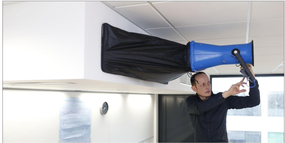
Bild 4: Komfortlüftung mit passivem Wärmeübertrager in der Leonore-Goldschmidt-Schule in Hannover-Mühlenberg. © Foto: Janko Woltersmann
