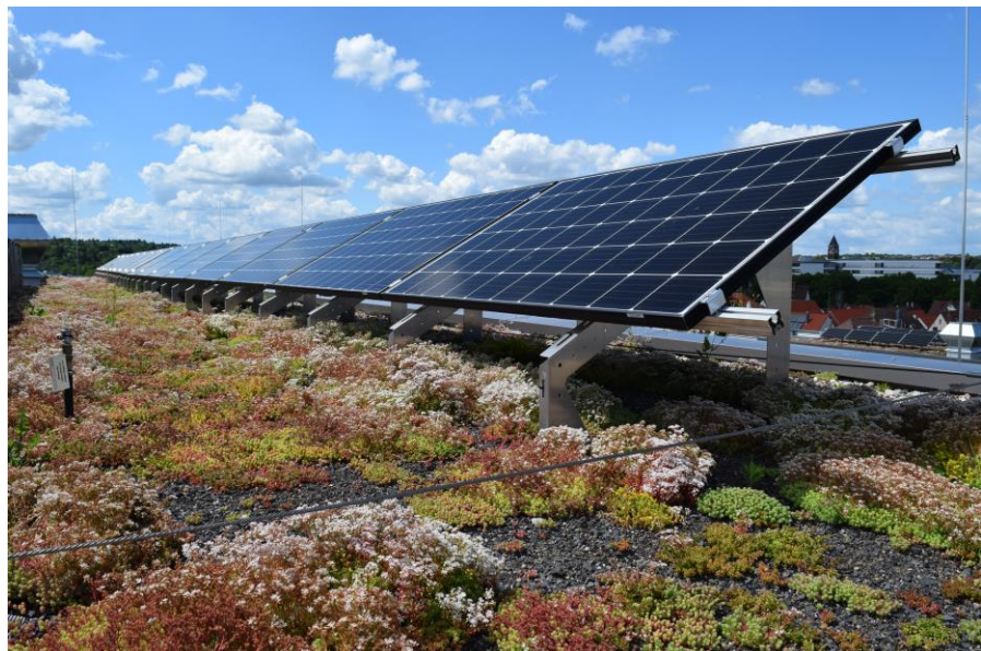
Bild 4: Solar-Gründach auf der Volksbank in Stuttgart. © Foto: G. Mann
