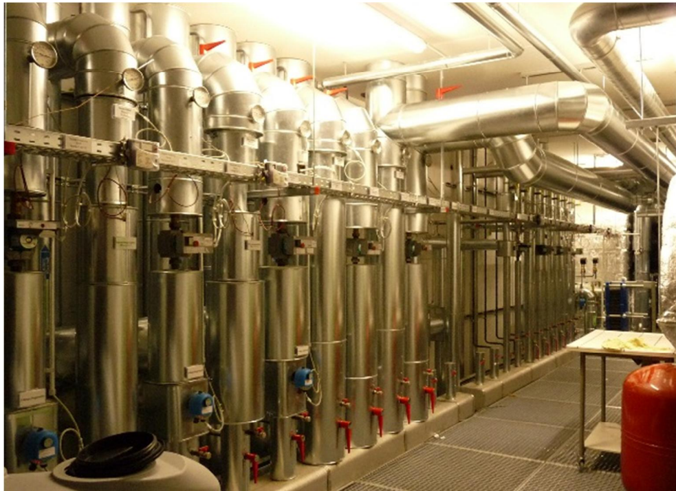
Bild 6: Technikzentrale der FOS/BOS Erding. Abgebildet ist im Vordergrund der Heizkreisverteiler und im Hintergrund der Kaltwasserverteiler. Nachdem die Schule mit dem Fernwärmerücklauf geheizt und mit Außenluft bzw. teilweise mit Grundwasser gekühlt wird, sind keine Kesselanlagen oder Kältemaschinen erforderlich. Alle Kreise wurden mit Wärme-/Kältemengenzählern ausgestattet und über ein Bussystem ausgelesen.
