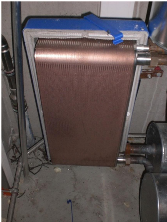
Bild 4 + 5: Plattenwärmeübertrager als Systemtrennung der Geothermiewärmeversorgung zwischen dem Nachbargebäude und der FOS/BOS Erding vor (oben) und nach (unten) der Optimierung. Dabei wurden die Systemtemperaturen erheblich abgesenkt.
