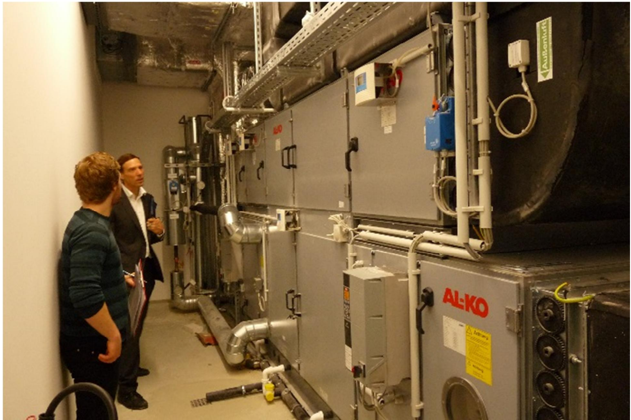
Bild 7: Dr. Kuckelkorn und einer seiner Mitarbeiter bei Überprüfung des Betriebs der Lüftungsanlagen. Abgebildet ist hier die RLT-Anlage mit Wärmerückgewinnung für den Küchenbereich.
