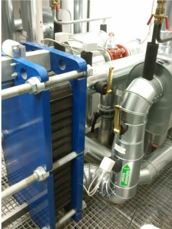
Bild 8: Wärmeübertrager der Grundwasserkühlung zur Zuluftvorkonditionierung und zur Kühlung von EDV-Räumen. Der Wärmeübertrager konnte durch regeltechnische Optimierung so umfunktioniert werden, dass dieser die Funktion eines erforderlichen Kältespeichers übernimmt. Eine Nachrüstung konnte dadurch vermieden werden.
