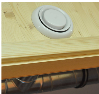
Abbildung 7: Beispiel Zu- und Abluftöffnungen
